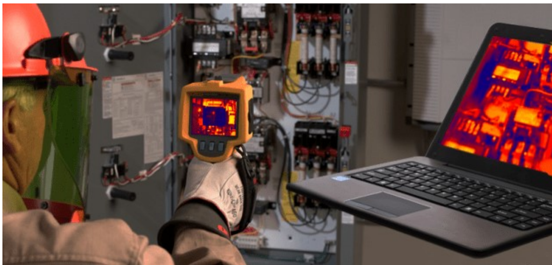
Рисунок 20. Пример проведения тепловизионного контроля электрошкафа
